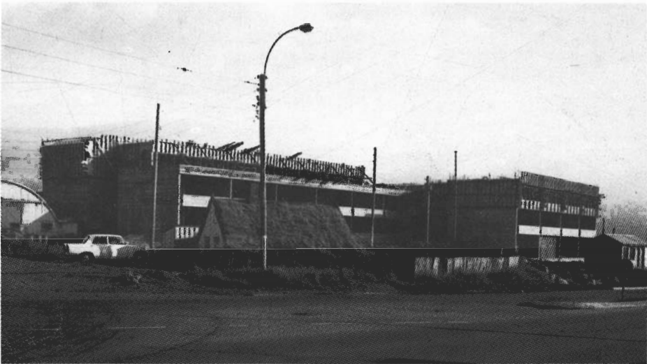
Hjónagarðar í byggingu. Torfbærinn smái við nýbygginguna hét Litla-Brekka og mun hafa verið byggður um 1890. Þar hjó lengi Eðvarð Sigurðsson alþingismaður, formaður verkamannafélagsins Dagsbrúnar. Litla-Brekka var rifin 1981.
